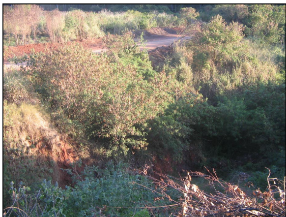
FOTO 18 - Erosão – acesso à rua Iguazu e Vila Josefina F. Lunardelli
