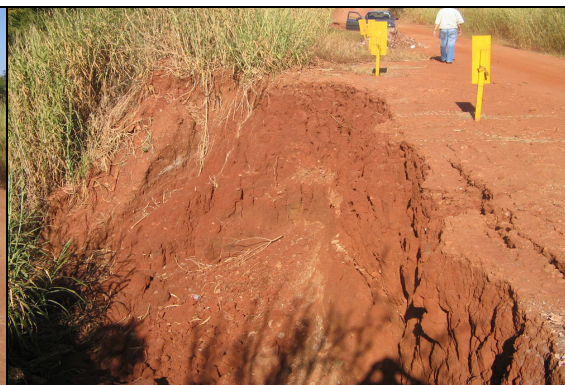
FOTO 21 Desmoronamento do Aterro – Água dos Carrapatos.
