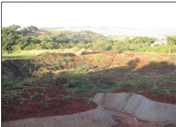
FOTO 14 - Caixas de contenção – Emissário transposição PR 170
